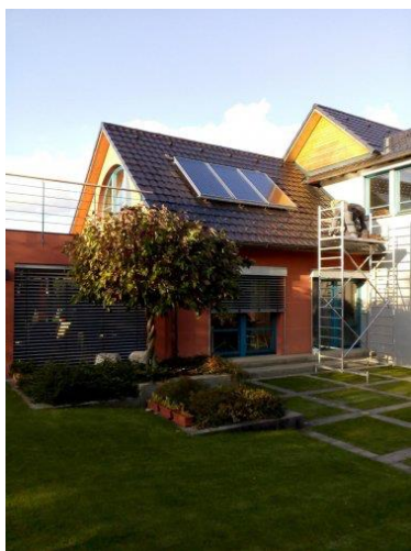
Realizácia - O kres Zlaté Moravce - systém SOLAR 4 kWp solárne kolektory na ohrev TUV
